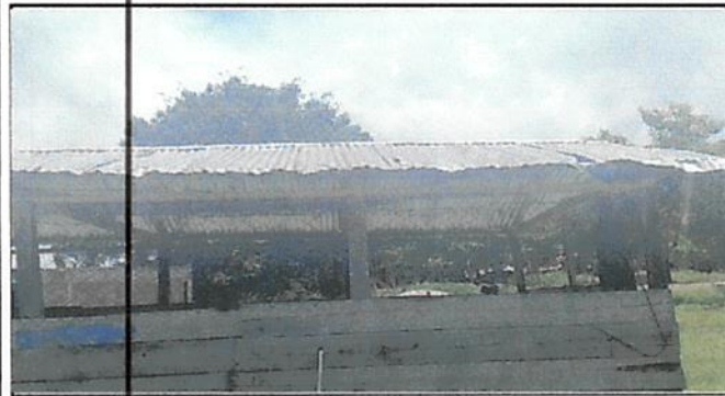
Foto 3: ASÍ SE MIRABA LA COCINA ANTES DE REALIZAR LOS CAMBIOS DE LAS ESTRUCTURAS QUE ESTABA MUY DETERIORADAS.
