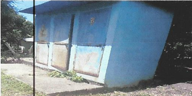
Foto 1: ASÍ ERA EL BAÑO ANTES DE LA INTERVENCIÓN QUE ESTABA MUY DETERIORADA Y INCLINADA POR UN LADO A PUNTO DE CAERSE.
