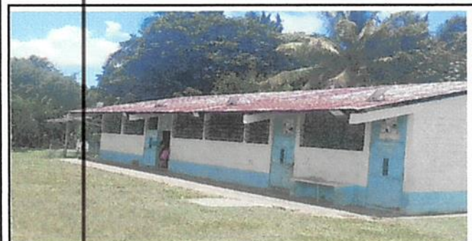
Foto 5: ASÍ ERA LAS AULAS ANTES DE LA INTERVENCIÓN CON LA PINTURA
